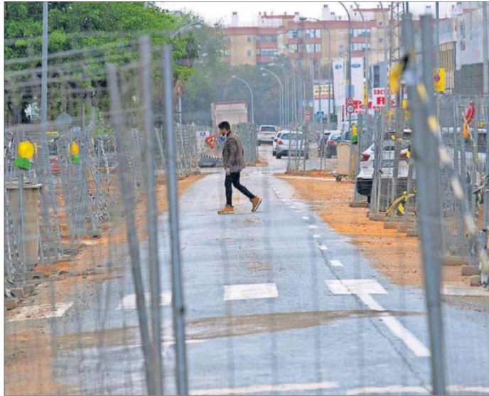
Una de las calles del polígono industrial Calonge, en Sevilla, ayer con las obras paradas. / PACO PUENTES
