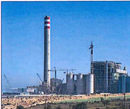
Vista de una planta térmica en Safi (Marruecos).
