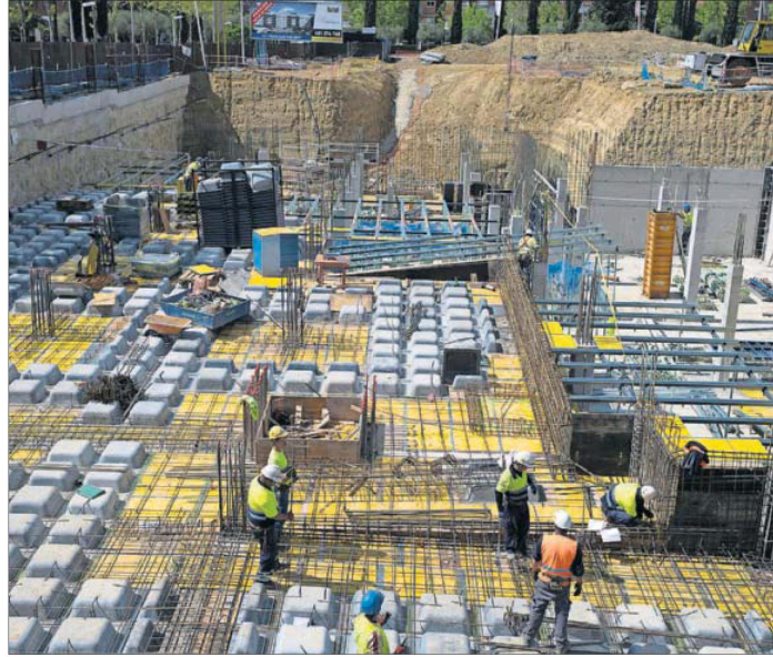
Obreros trabajando en la construcción de un edificio en Bormujos (Sevilla), la semana pasada. / PACO PUENTES
